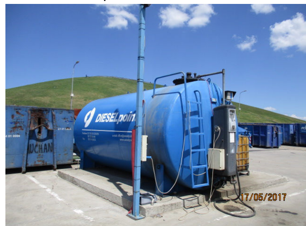
Figura 12 Statie alimentare combustibili
