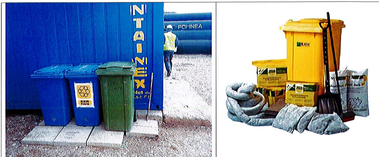
Figura 10. Model organizare de șantier realizată din containere modulare (stânga) și model de amenajare a zonei sanitare, cu toaletă modulară cu bazin etanș, vidanjabil, tratat chimic, lavoar modular și pichet PSI; model kit de depoluare tip KIT240L 11
