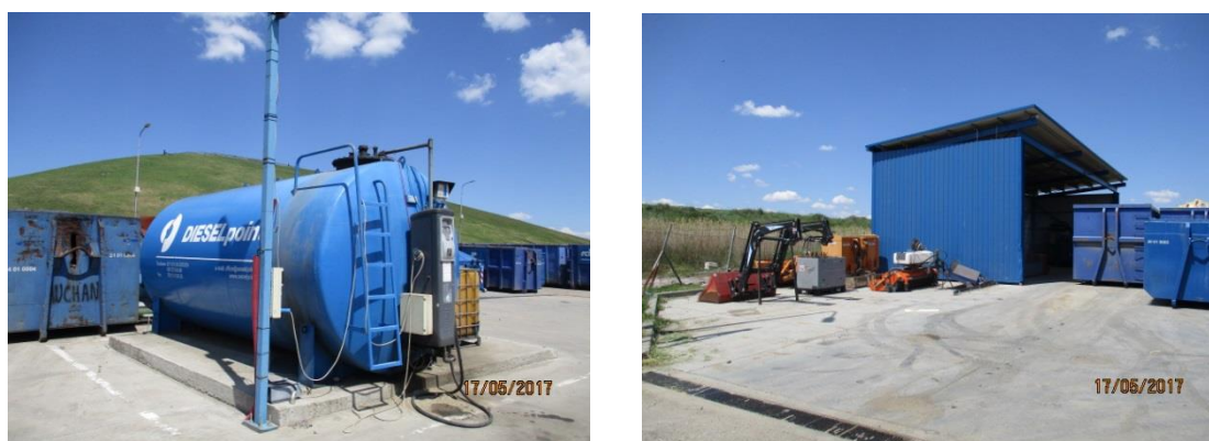
Imagine 6 Stație alimentare combustibil și depozit de uleiuri
