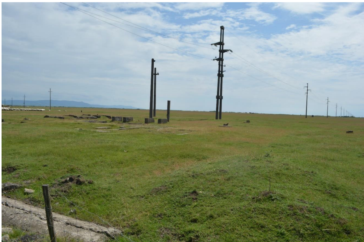
LEA 20kV ce traverseaza amplasamentul
