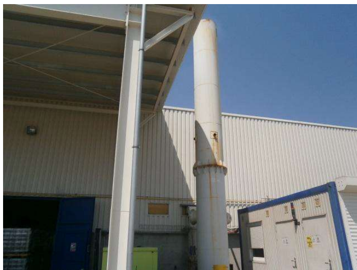
Fig. 5 Coș pentru evacuarea noxelor exhaustate
