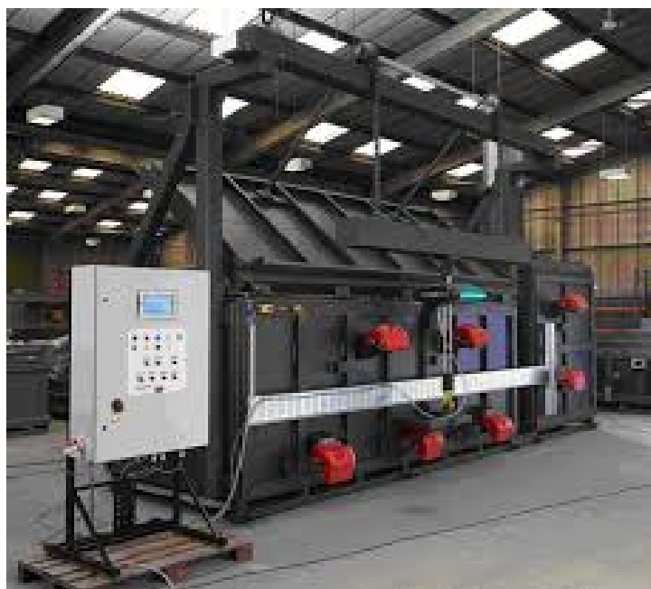
Figură 8: vedere incinerator din spate (zona arzătoarelor)
