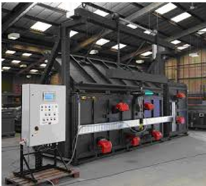
Figură 2: vedere incinerator din spate (zona arzătoarelor)
