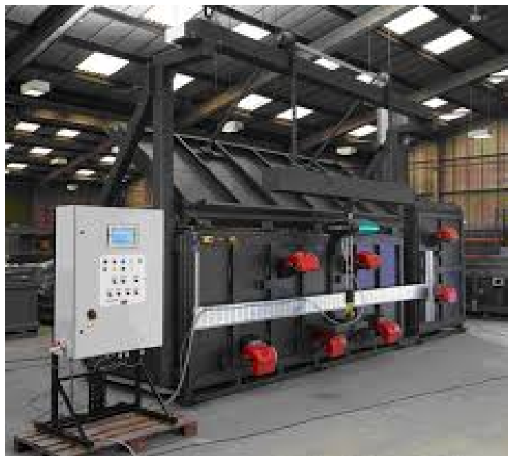
Figură 2: vedere incinerator din spate (zona arzătoarelor)
