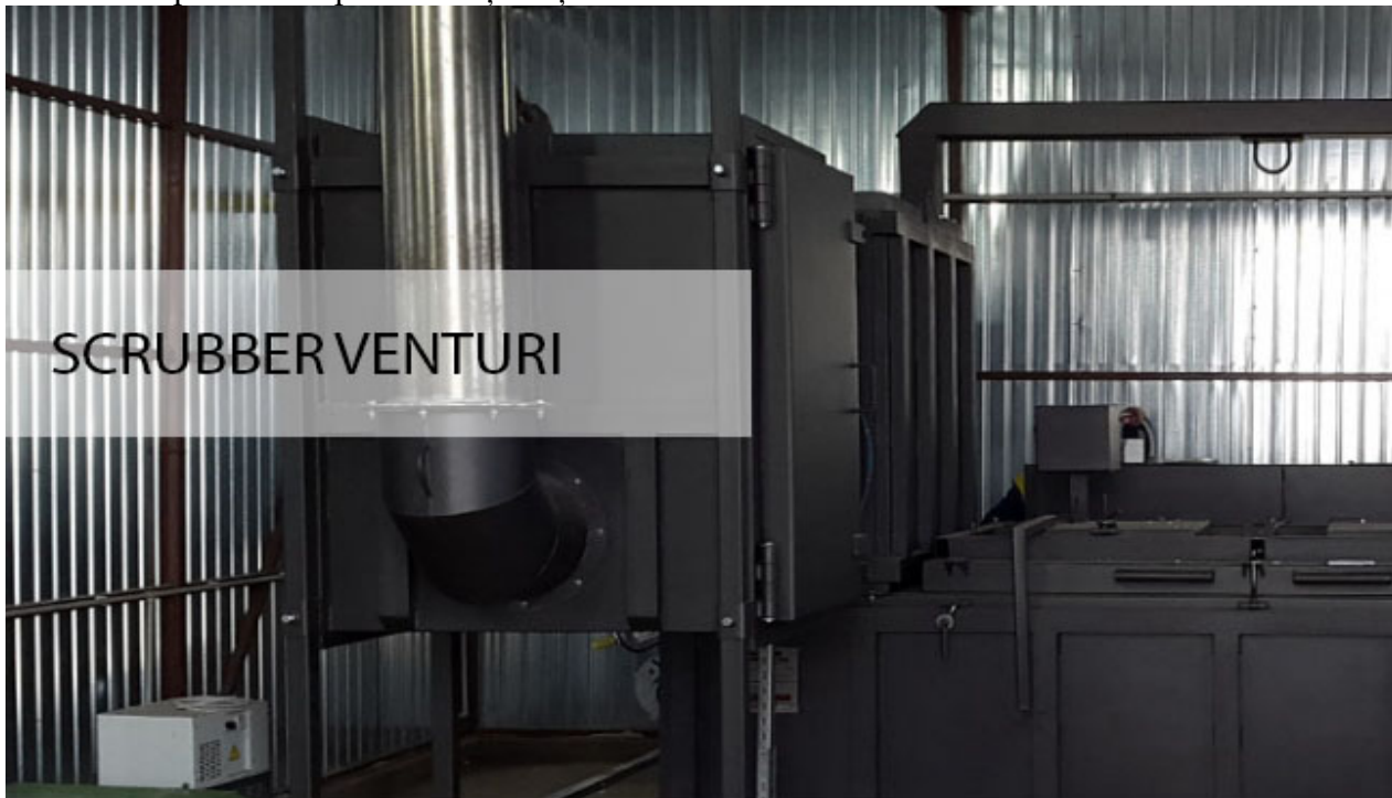
Figură 33: vedere spălător Venturi
