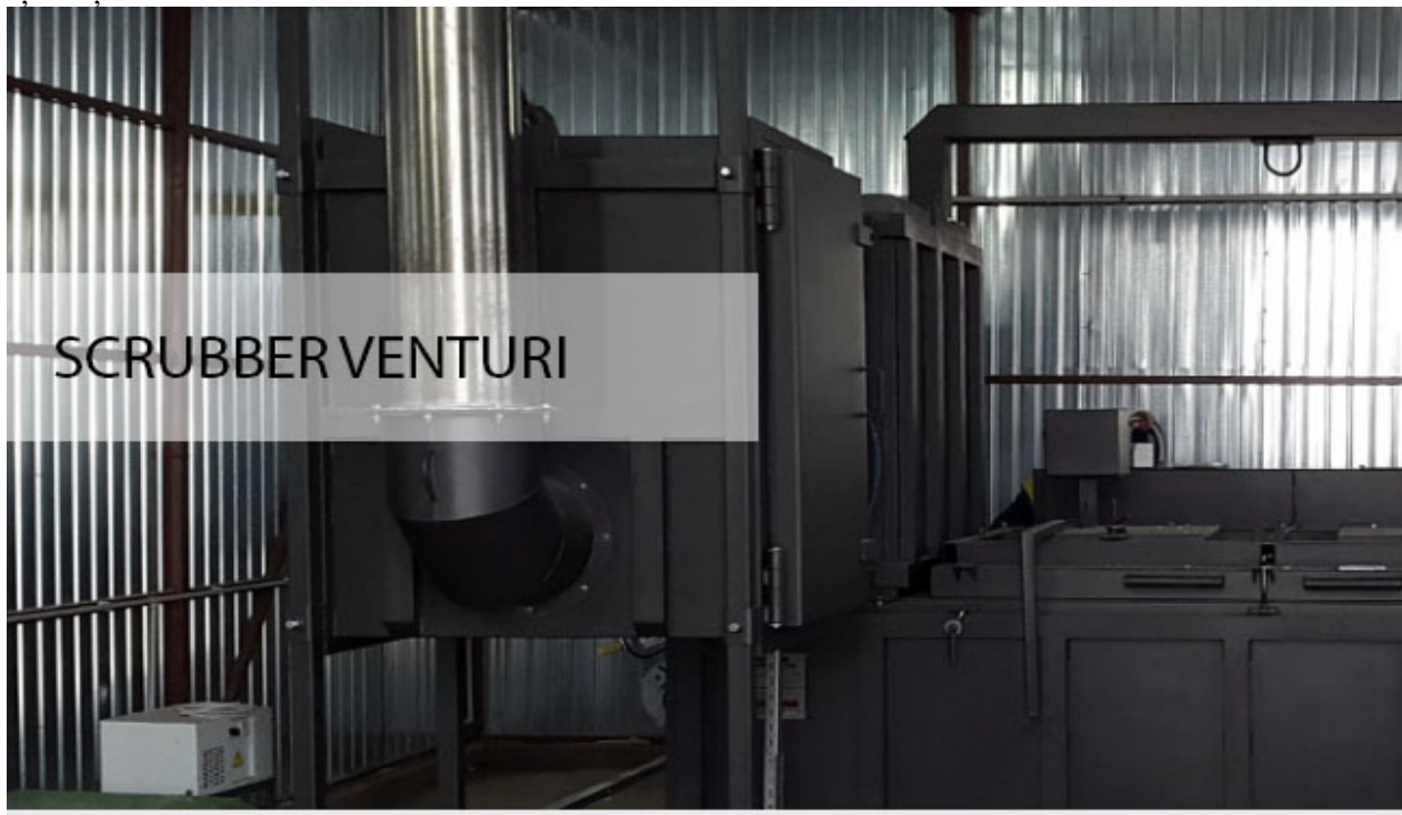
Figură 6: vedere spălător Venturi
