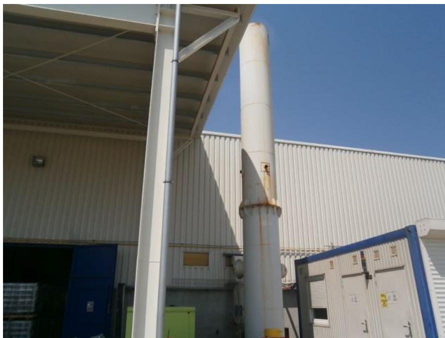
Fig. 5 Coș pentru evacuarea noxelor exhaustate
