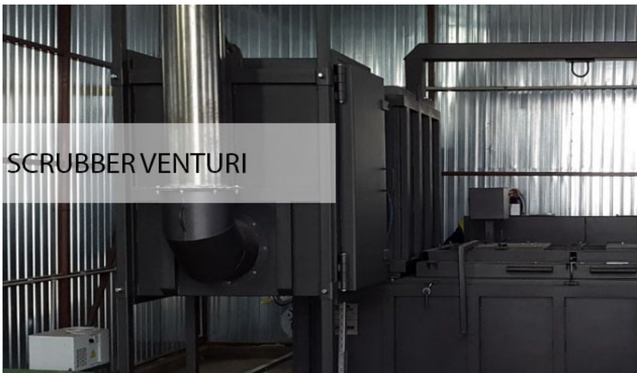
Figură 33: vedere spălător Venturi
