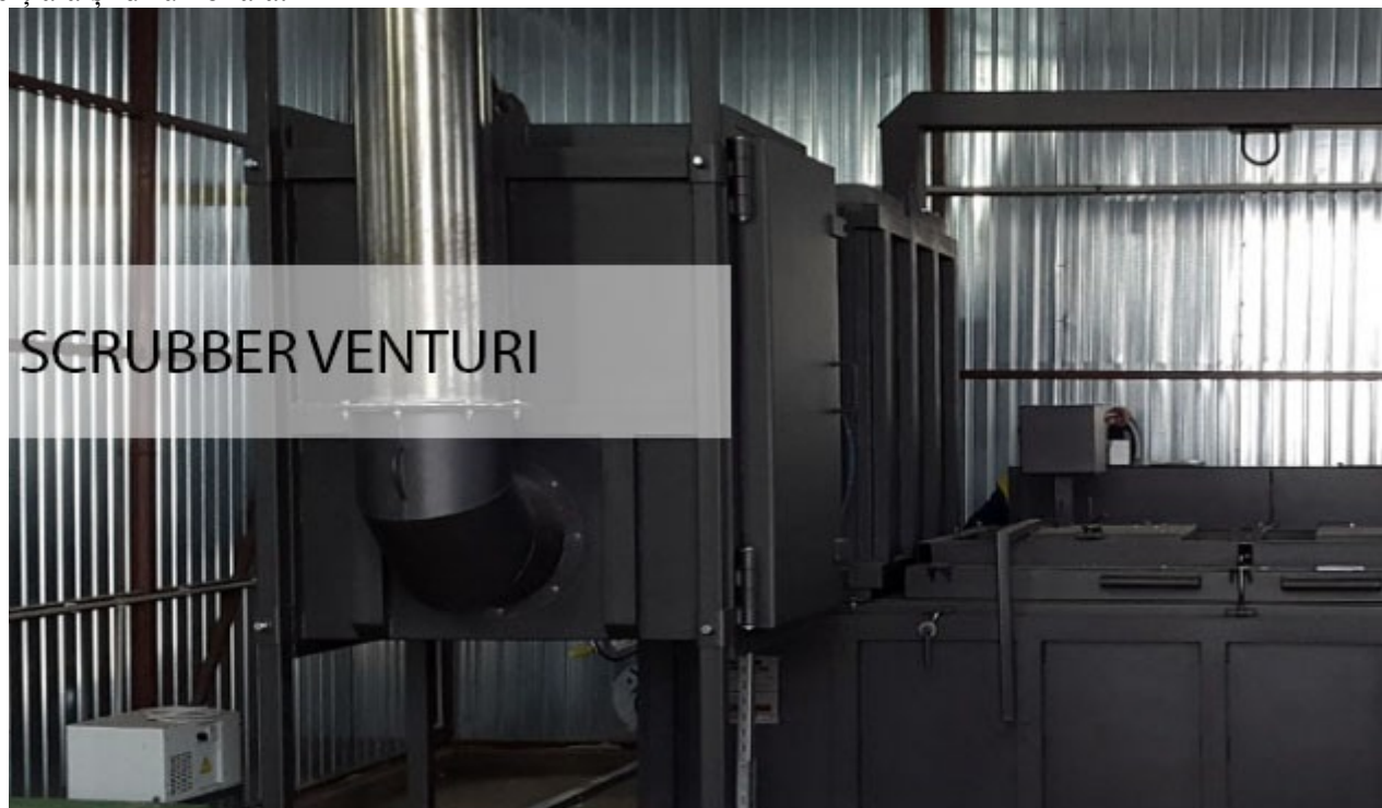
Figură 6: vedere spălător Venturi
