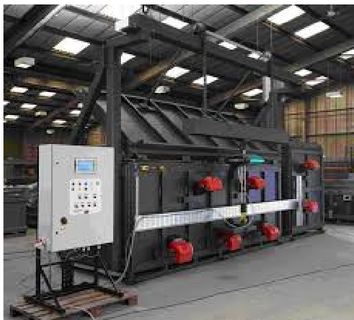
Figură 2: vedere incinerator din spate (zona arzătoarelor)
